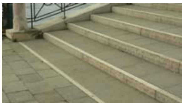
Fig. 7 – Falso gradino creatosi dopo i lavori di innalzamento della pavimentazione per la salvaguardia della città dalle acque alte. La striscia di pietra d'Istria allo stesso livello della fondamenta viene percepita, in discesa, come un normale gradino, rappresentando quindi una vera e propria barriera percettiva.
